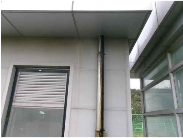
손상내용 전기실 외부 누수흔적 손상원인 수분접촉
