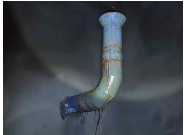
손상내용 2지 유입배관 부식 손상원인 공용열화
