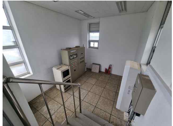
전기실 내부 전경
