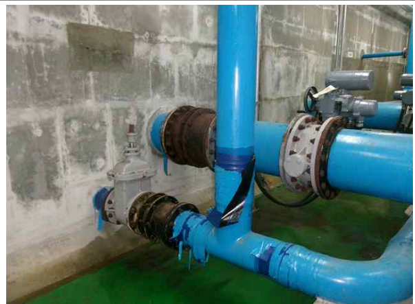
손상내용 유출밸브실 배관 부식 손상원인 공용열화
