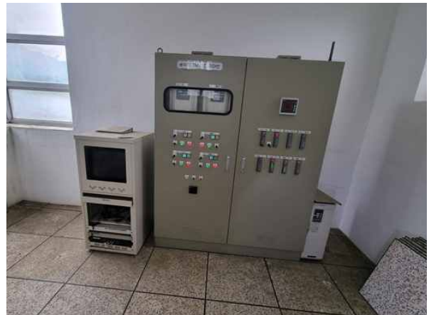
손상내용 현장제어반 상태양호
