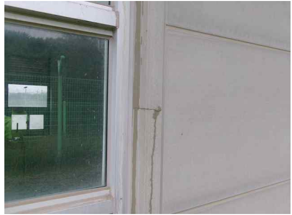
손상내용 전기실 외부 벽체 균열 손상원인 건조수축, 온도변화
