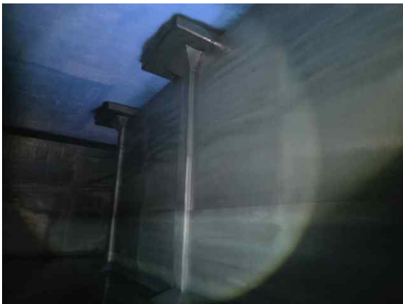
손상내용 2지 도류벽 상태양호 손상원인 -
