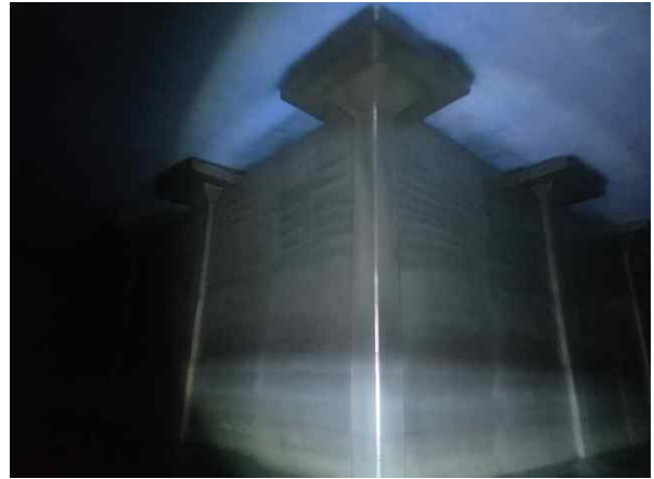
손상내용 2지 기둥 상태양호 손상원인 -
