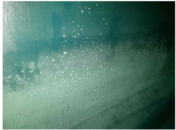
손상내용 1지 벽체 도장기포 손상원인 도장미흡
