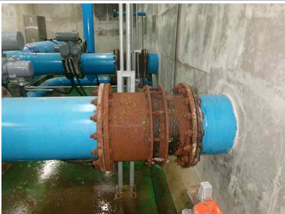
손상내용 유출밸브실 배관 부식 손상원인 공용열화
