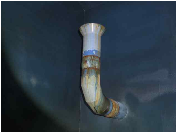
손상내용 1지 유입배관 부식 손상원인 공용열화
