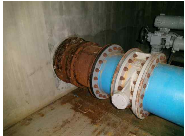
손상내용 유입밸브실 배관 부식 손상원인 공용열화
