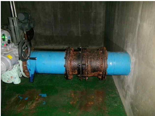
손상내용 유입밸브실 배관 부식 손상원인 공용열화
